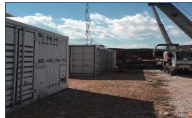
35kV/4MVA新能源测试平台
